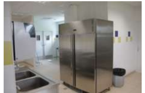
L'office, vue de l'armoire frigorifique
